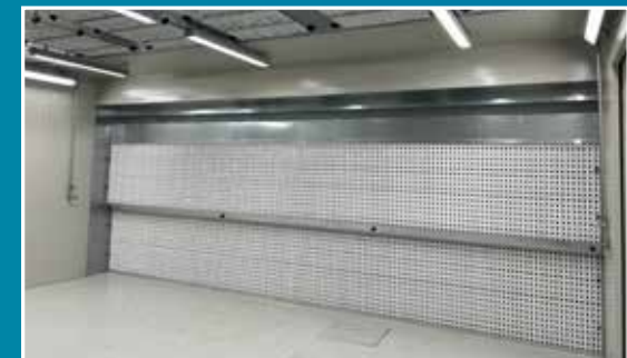
PARTICOLARE ZONA DI VERNICIATURA DETAIL OF PAINTING ROOM
